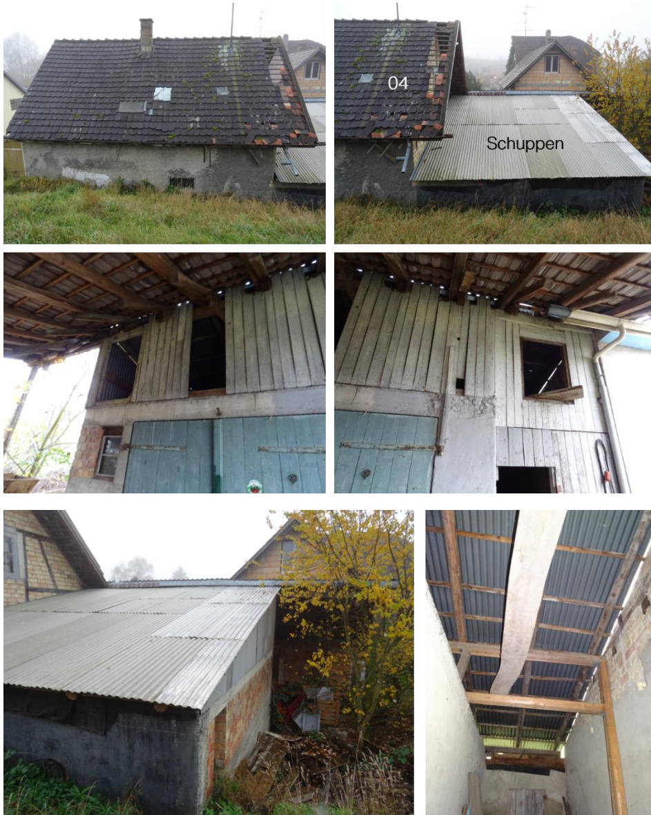
Abbildung 10: Fotos Gebäude 04 mit dem baufälligen Schuppen
